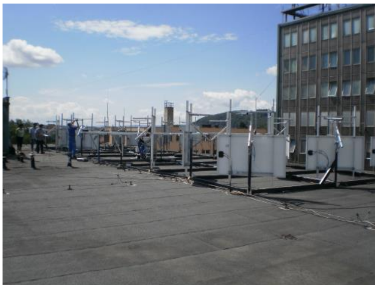
Obr. 28 Časť laboratória lokalizovaná v Prešove – fotovoltické panely
