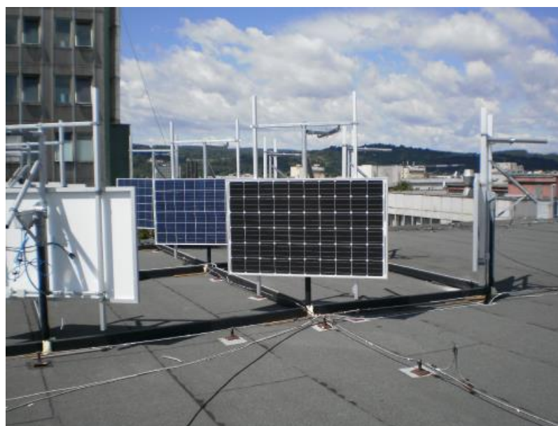
Obr. 31 Rôzne konštrukčné vyhotovenie a orientácia fotovoltických panelov rôznym smerom – pohľad spredu
