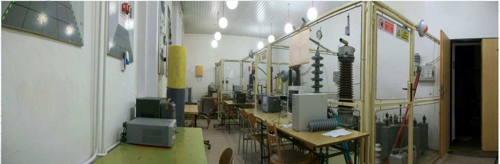
Laboratórium techniky vysokých napätí
