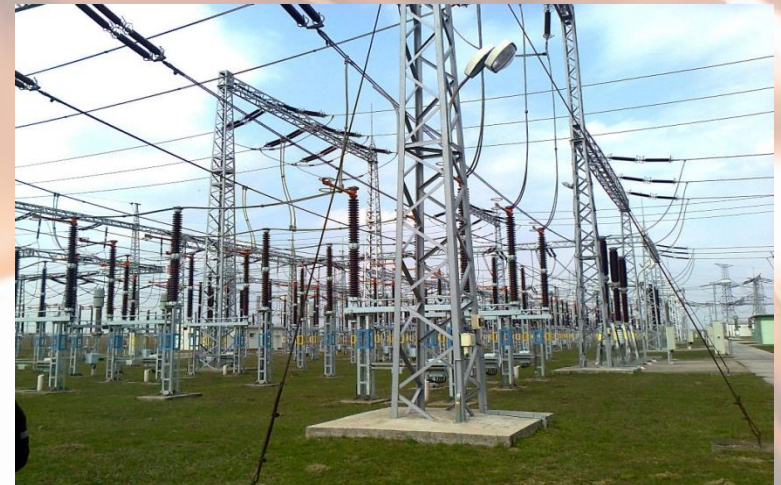
Exkurzia v rozvodni v Križovanoch nad Dudváhom
