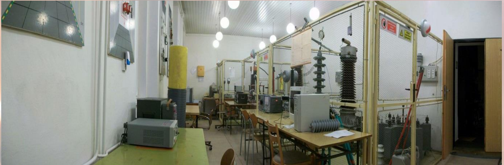
Laboratórium techniky vysokých napätí
